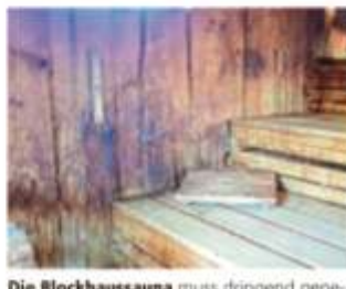
Die Blockhaussauna muss dringend generalsaniert werden.
