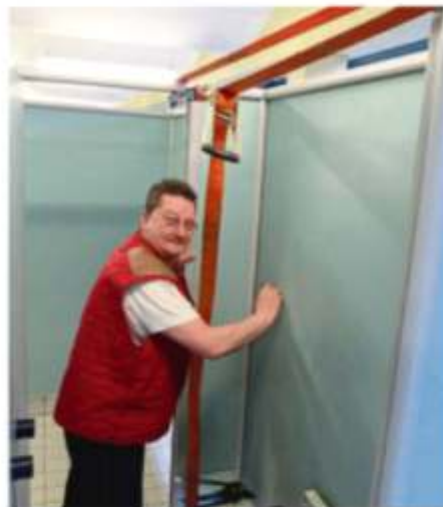
Mit Spanngurt und Schraubenzieher versucht Mitarbeiter Frank Wagner, die Umkleide-Trennwände zu stabilisieren.
